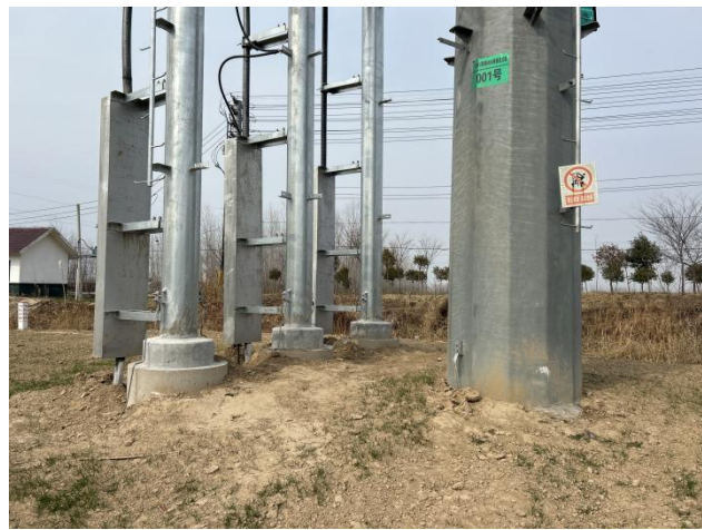
110kV 梁蒋 8A50 线睿晶支线 1#杆塔警示和防护指示标志示例
